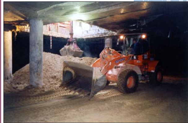
Рис. 12. Многофункциональный комплекс «Арбат-Центр» в Москве. Транспортировка разрабатываемого грунта автопогрузчиком «Hitachi W130» к временному монтажному проему во время экскавации 2-го яруса котлована. Выдача грунта на поверхность под погрузку в автосамосвалы грейфером экскаватора «Hitachi EX300-5».
