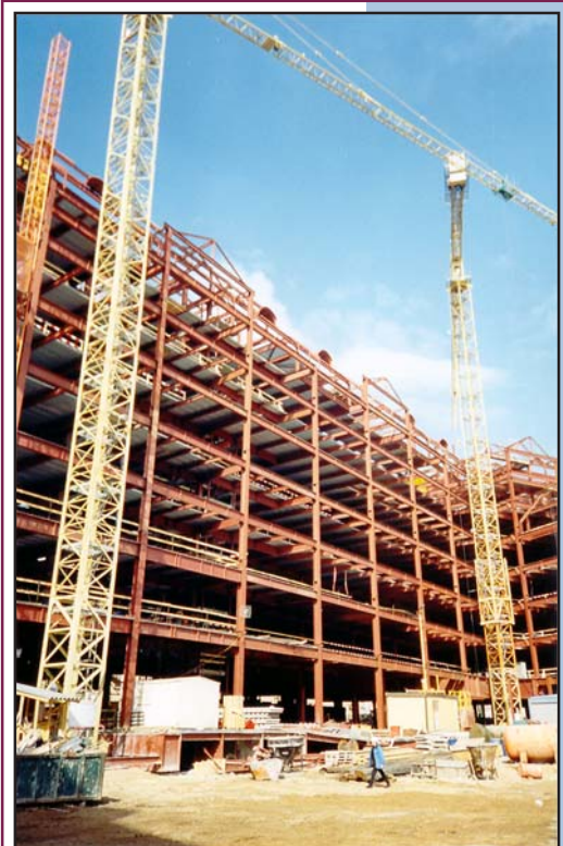
Рис. 6. Многофункциональный комплекс «Арбат-Центр» в Москве. Возведение металлического несущего каркаса главного корпуса после возведения траншейных стен подземной автостоянки.
