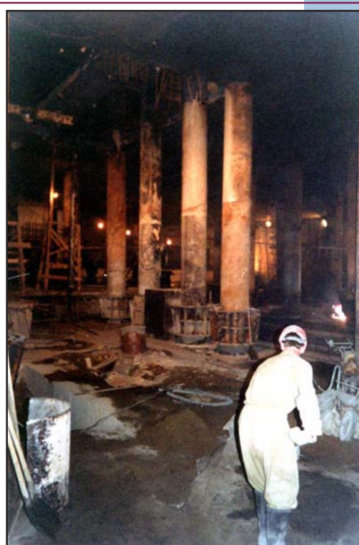
Рис. 2. Многофункциональный комплекс «Царев сад» в Москве. «Вывеска» лифтовых и вентиляционных шахт ядра жесткости надземной 8-этажной части Строения 1 на буровых колоннах.
