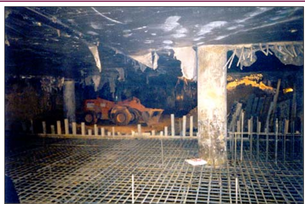
Рис. 19. Многофункциональный комплекс «Арбат-Центр» в Москве. Завершение экскавации грунта на 5-м ярусе в зоне монтажного проема.
