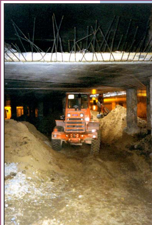
Рис. 14. Многофункциональный комплекс «Арбат-Центр» в Москве. Транспортировка грунта к временному монтажному проему автопогрузчиком «Hitachi W130» во время разработки грунта на 3-м ярусе котлована под рампой -2-го этажа на западной половине автостоянки.
