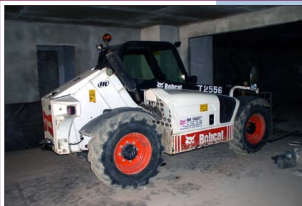
Рис. 16. Многофункциональный комплекс «Арбат-Центр» в Москве. Доставка отделочных материалов по рампе на -3-й этаж малогабаритным автопогрузчиком во время экскавации грунта на 5-м ярусе котлована.
