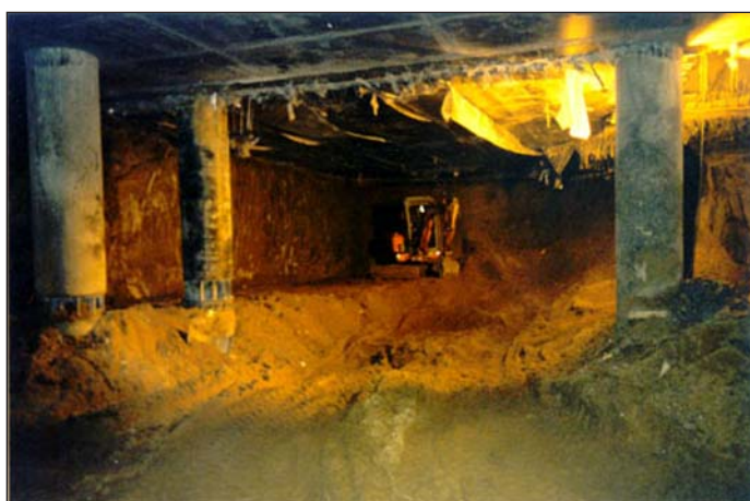
Рис. 13. Многофункциональный комплекс «Арбат-Центр» в Москве. Экскавация грунта на 3-м ярусе котлована под рампой -2-го этажа на западной половине автостоянки.
