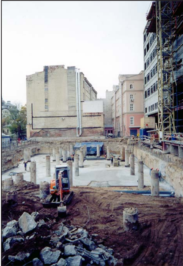
Рис. 5. Возведение первой половины перекрытия над 2-м этажом безопалубочным способом. Подготовка грунтового основания.
