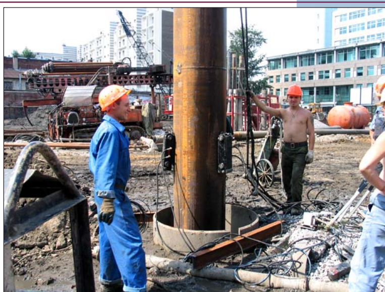
Рис. 9. Монтаж извлекаемых гидродомкратов на трубе-опалубке арматурного каркаса буровой колонны увеличенной глубины заложения.
