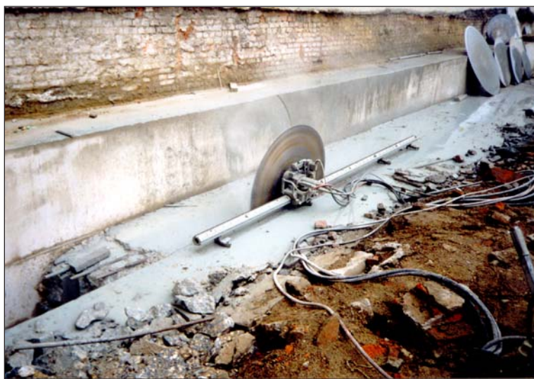
Рис. 4. Устройство форшахты и прорези под будущую стену ограждения котлована в старой фундаментной плите, обнаруженной возле гостиницы «Националь».
