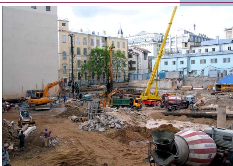
Рис. 7. Возведение буровых колонн вдоль стен под защитой ограждения котлована из буросекущихся свай.
